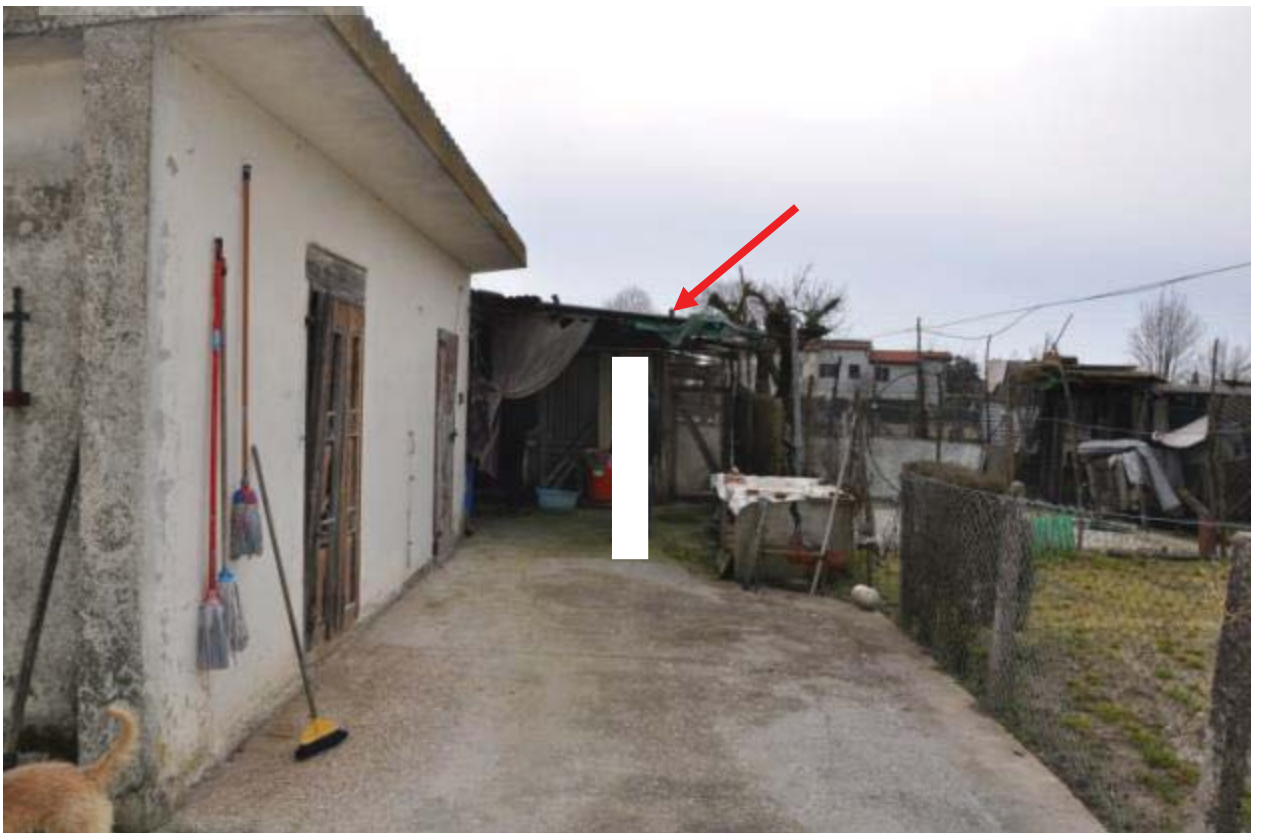
12 Fabbricato lato ovest (in rosso indicata la tettoia abusiva).
