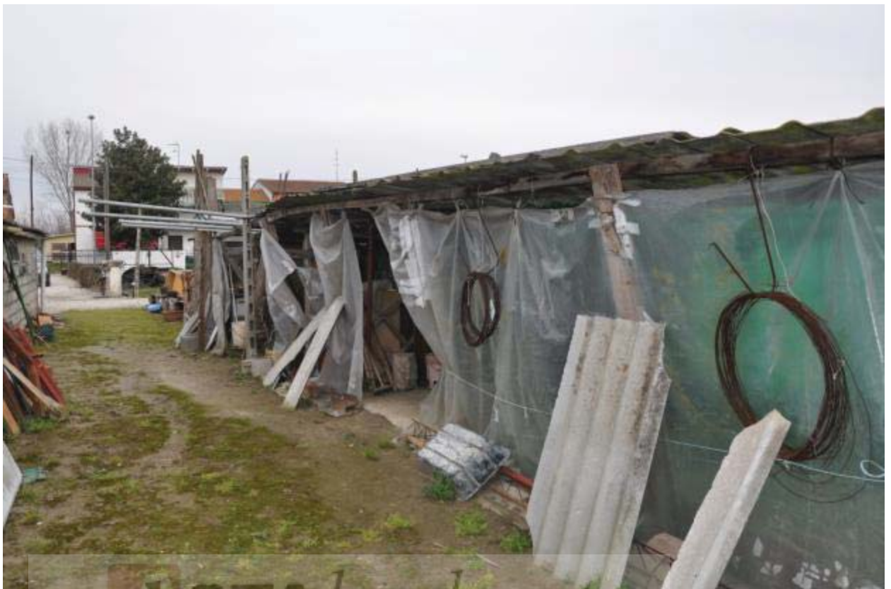
19 Tettoie abusive con tetto in Eternit.
